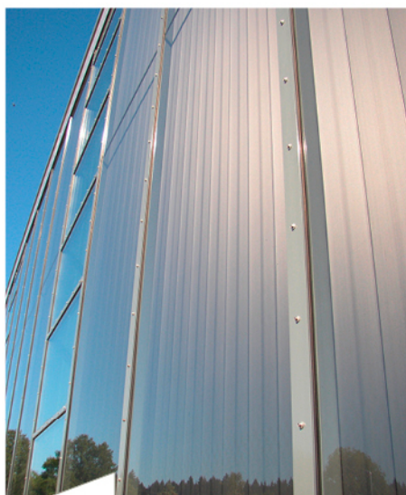
Die thermischen Solarabsorber sind vollkommen in die Pfosten-Riegel-Fassade integriert.
