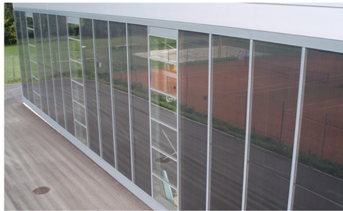
Die Fassade mit den integrierten thermischen Kollektoren
