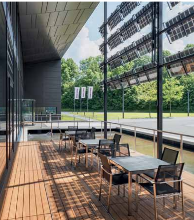
Eine Sonnenstand geführte PV-Anlage an der Fassade gilt als die Edelvariante regenerativer Energieerzeugung.
